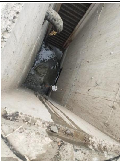
污水处理站进水
