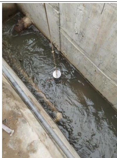
污水处理站出水
