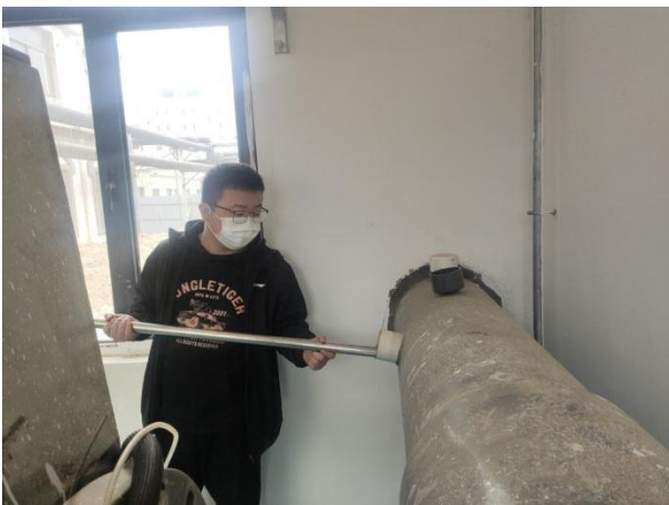
污水处理站废气处理设施进口
