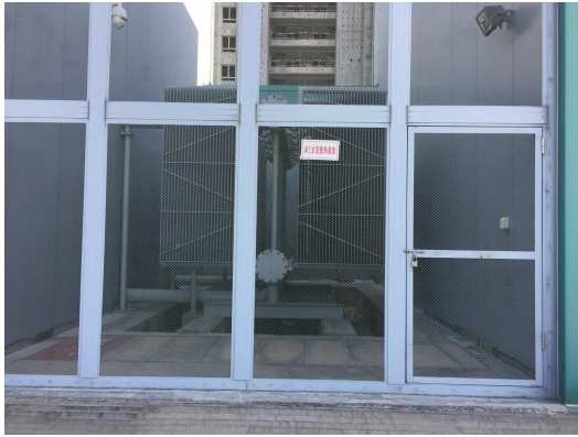
图 4-10 1#主变散热器室
