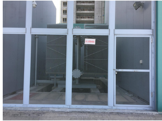
图 4-11 2#主变散热器室
